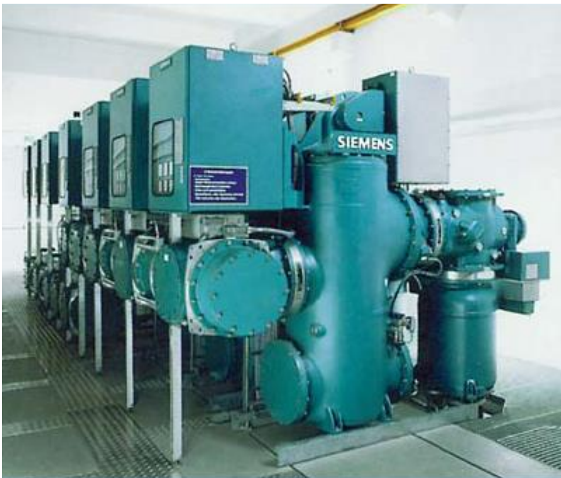
Рис. 3.16. Внешний вид ЗРУ-110 кВ фирмы SIEMENS
