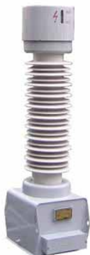
Рис. 3.11. Трансформатор напряжения однофазный антирезонансный НАМИ-110
