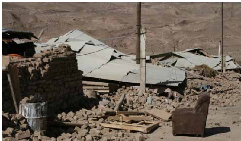
Рис. 5. Разрушенные постройки после землетрясения
